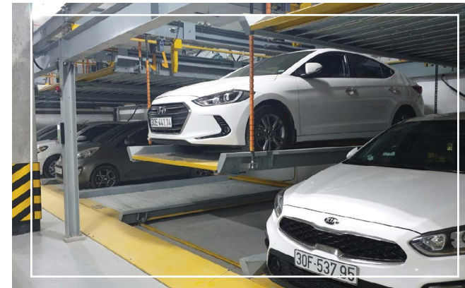
Hệ thống đỗ xe tự động, thang nâng ô tô tại tòa nhà NHS Automated parking system, car lifts at NHS building
