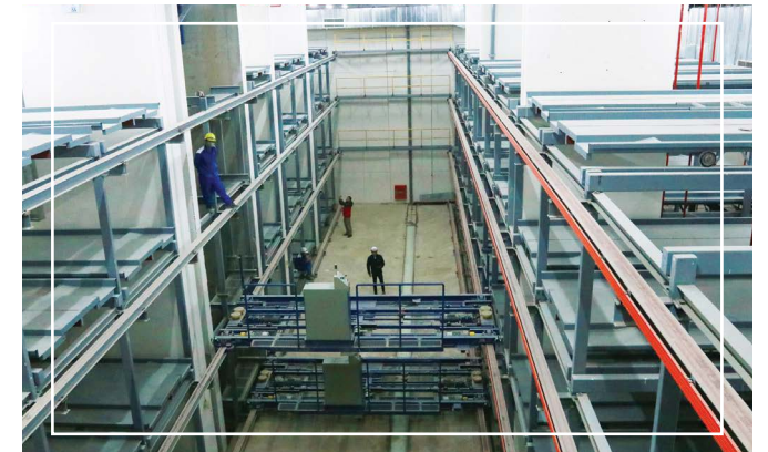
Hệ thống đỗ xe tự động tại tòa nhà Tudi Automated parking system at Tudi Building
