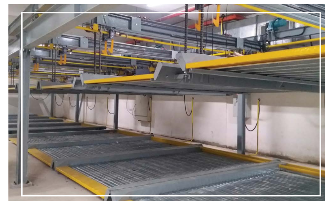
Hệ thống đỗ xe tự động tại khu phức hợp Monarchy Automated parking system, car lifts at Monarchy Complex
