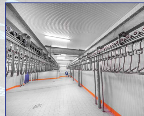
Kho đông lạnh Cold storage
